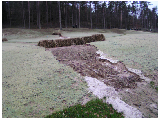
Bilde 3: I anleggsfasen er det fare for jorderosjon og forurensning av vassdrag.
